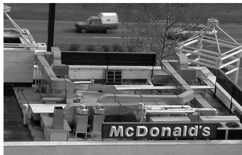
Postrojenja za klimatizaciju
