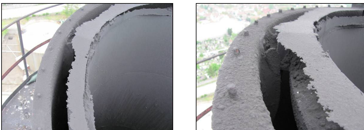
Slika 1.- Oštećenje vezivnog prstena čeličnog industrijskog dimnjaka TO Borča
