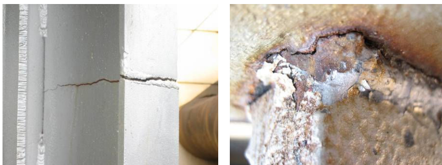
Slika 1: Oštećenje, prslina, na rebru korene strukture dimnjaka
